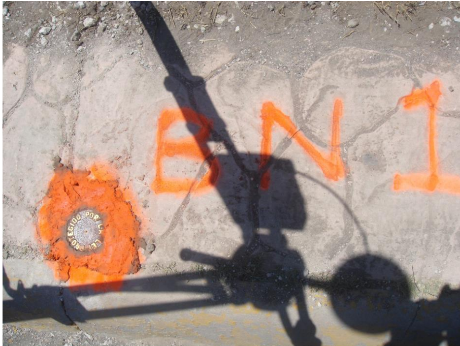
Trabajos de topografía para el Centro de Servicio Infonavit (CESI) Torreón, Coahuila.
