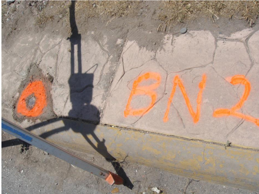
Trabajos de topografía para el Centro de Servicio Infonavit (CESI) Torreón, Coahuila.
