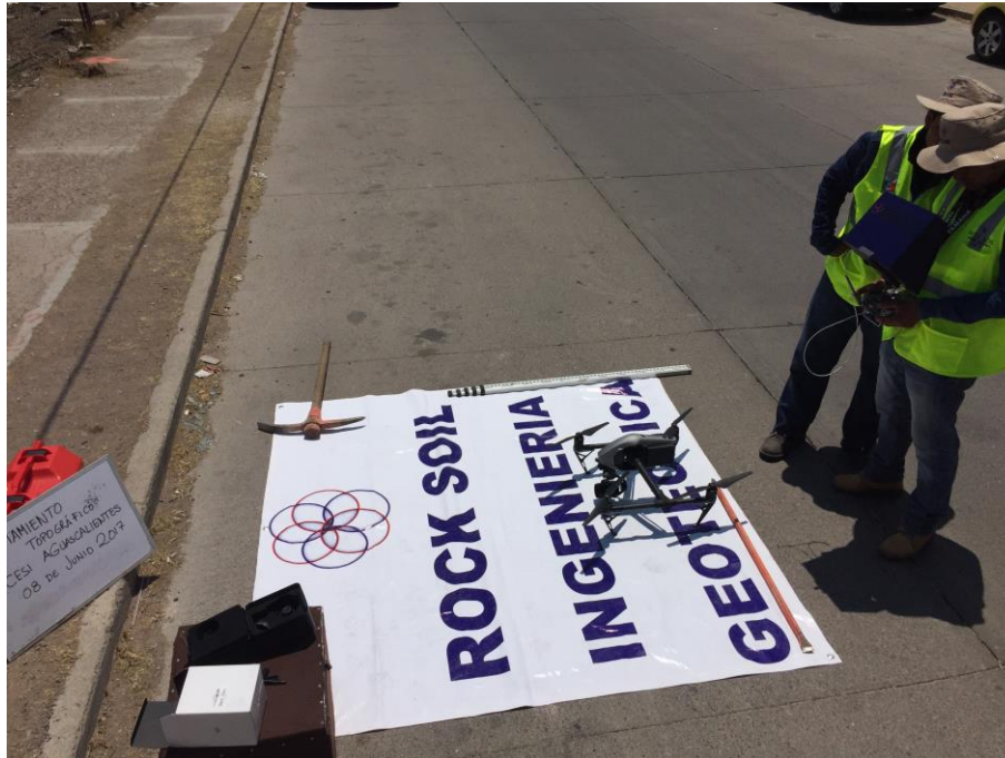
Trabajos de topografía para el Centro de Servicio Infonavit (CESI) Aguascalientes, Aguascalientes.
