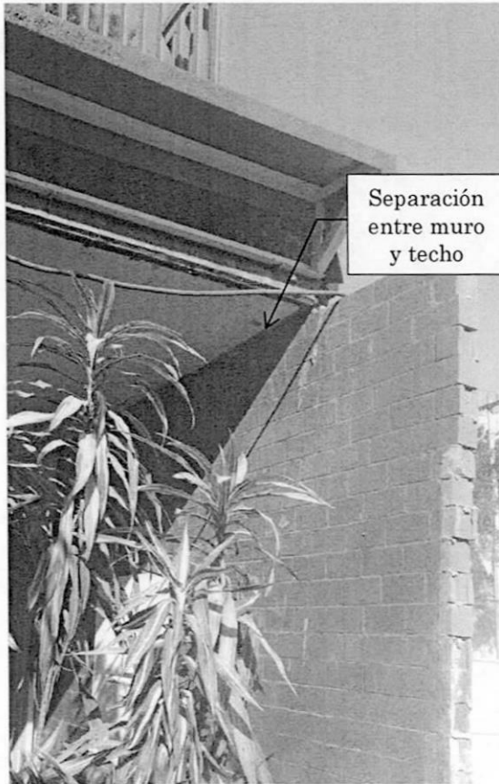
Foto 1. Separación milimétrica de muro y techo colindante en excavación.
