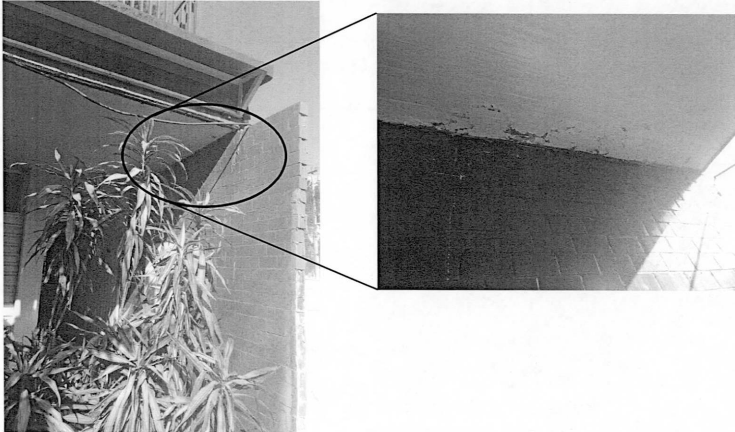
Foto 4 y 5. Separación de muro en colindancia
